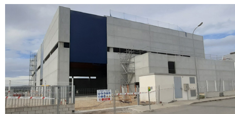
Una de les noves instal·lacions de Balfegó.
